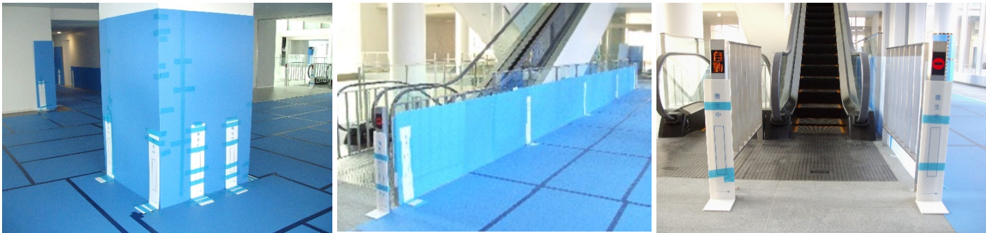
ウォールキーパーをエスカレーター入口に設置して使用
